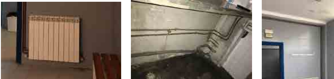
Fugas y envejecimiento en instalaciones y manchas de humedad.
