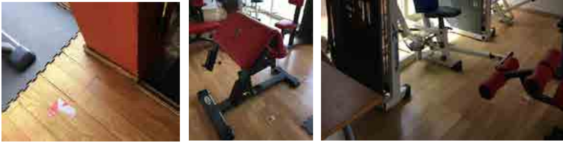
Solado de gimnasio, edificio de servicios.
